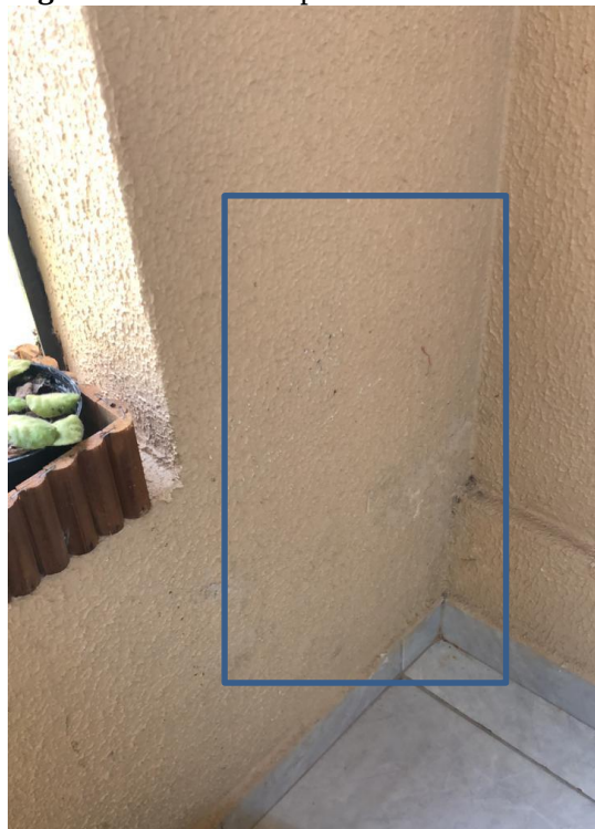
Figura D – Bolor nas paredes
