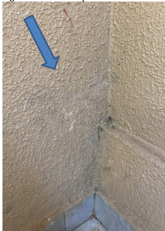
Figura E – Bolor nas paredes
