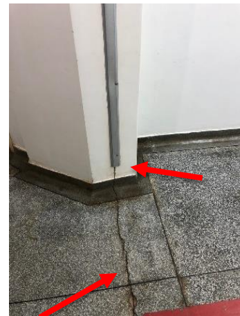
Rachadura no piso e pilar
