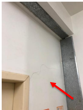
Fissura na parede
