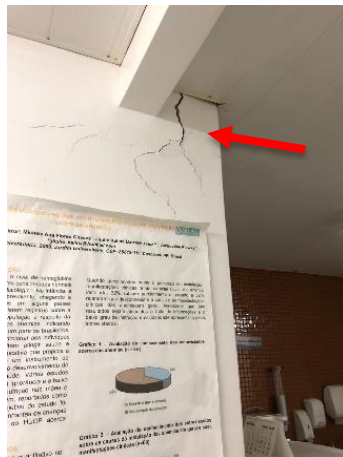
Rachadura na parede
