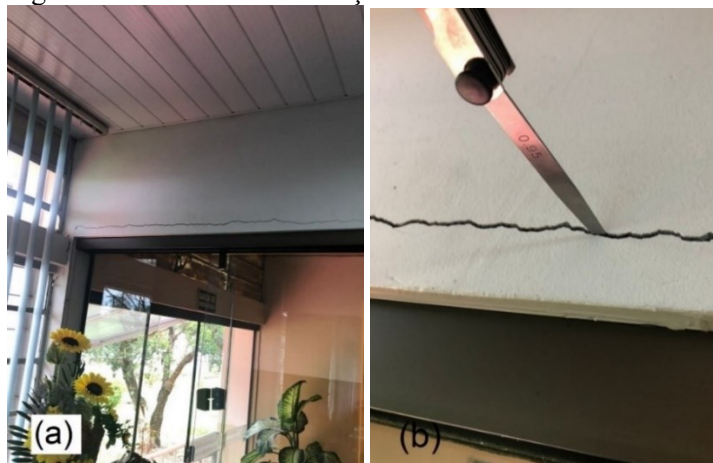
Figura 14 - Trinca na edificação.
