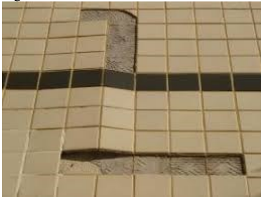
Figura 3 - Deslocamento revestimento cerâmico
