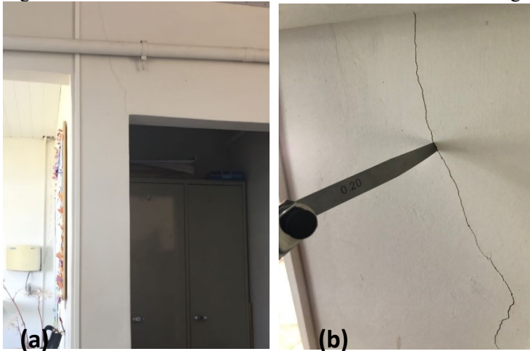
Figura 12 - Trinca no vértice da abertura devido à falta de verga.
