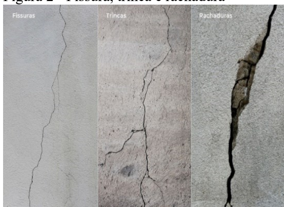
Figura 2 - Fissura, trinca e rachadura
