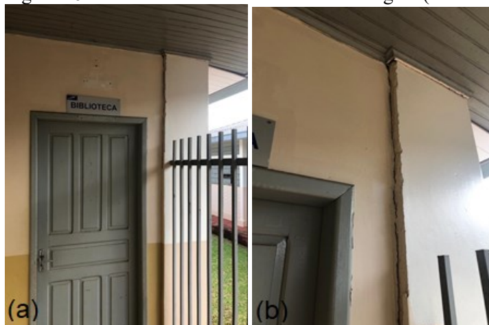
Figura 16 - Rachadura devido à falta de ancoragem (ferro cabelo).
