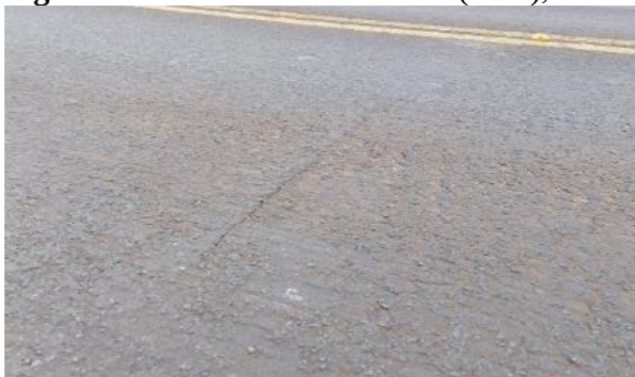
Figura 6: Trinca transversal curta (TTC), trecho do quilômetro 587.
