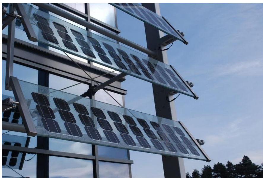
Imagem 02 - Aplicação de módulos fotovoltaicos em brises
