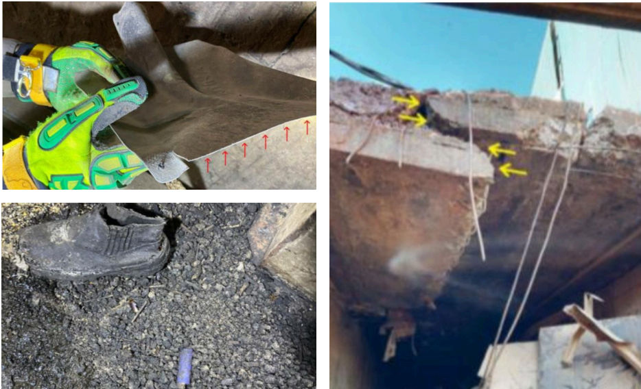
Figura 2. Evidências encontradas e Danos estruturais constatados
